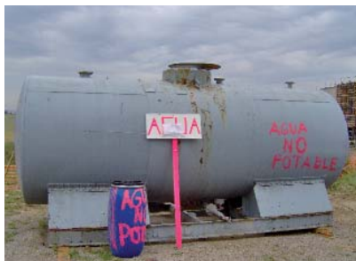
Dipòsit d'aigua no potable
